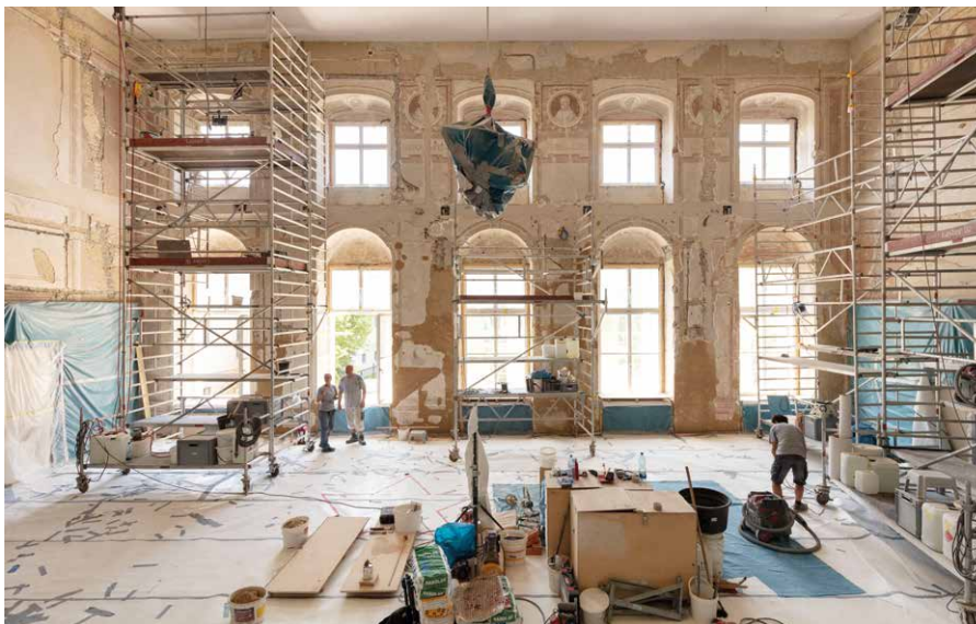
Im Zuge der umfassenden Sanierung wurden Bausünden aus den letzten Jahrzehnten rückgebaut, bauzeitliche Wandmalereien freigelegt und Asphaltwege im Hof entsiegelt.
